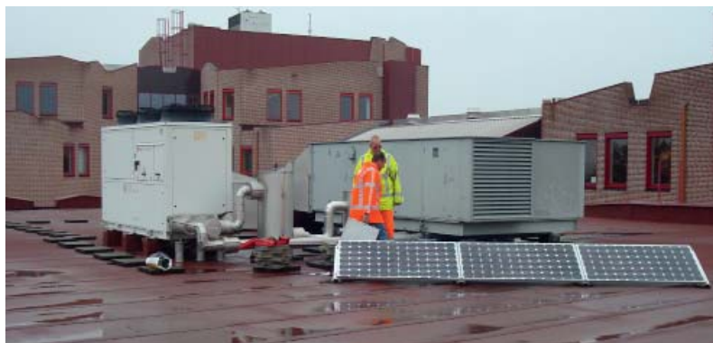
Zonnecellen op het dak van ROC de Leijgraaf in Oss.
